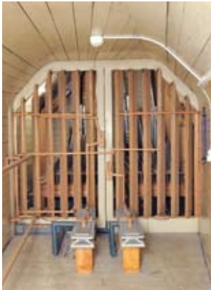
Blick auf die pneumatisch gesteuerten Schalousien des Fernwerks. Die beiden kleinen Bälge für die Steuerung sind im Vordergrund sichtbar.
